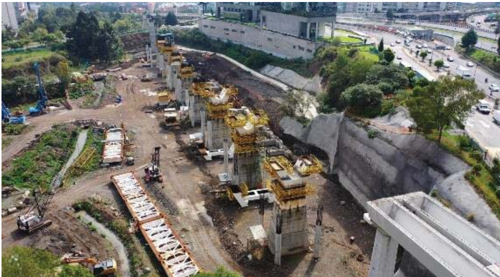
Armado y colado de pilas en sitio para la obra del Tren Interurbano México-Toluca
