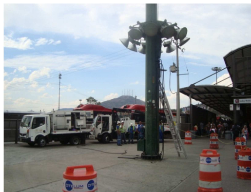
Apoyo de suministro de energía en la Terminal Indios Verdes del Metrobús
