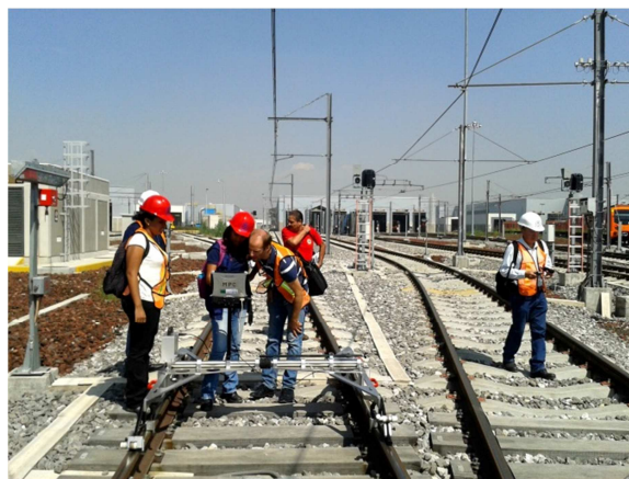
Medición de desgaste longitudinal de rieles
