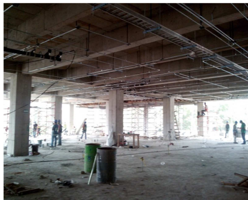
Canalización de instalaciones eléctricas
