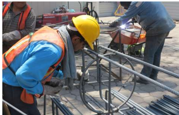
Armado y colado de pilas de contención para el desvío del Colector Río Becerra
