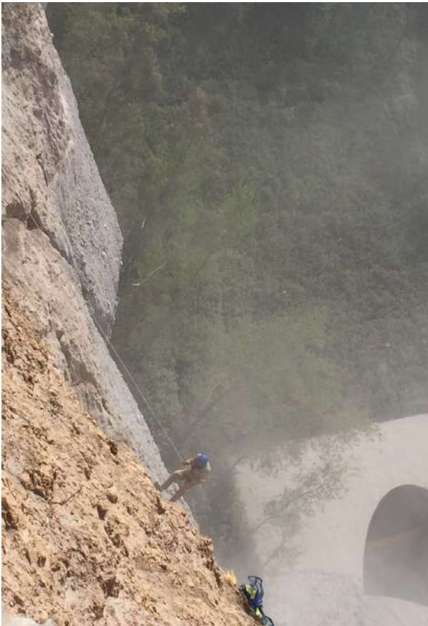
La seguridad en el desempeño de los trabajos es relevante para detectar las zonas más afectadas
