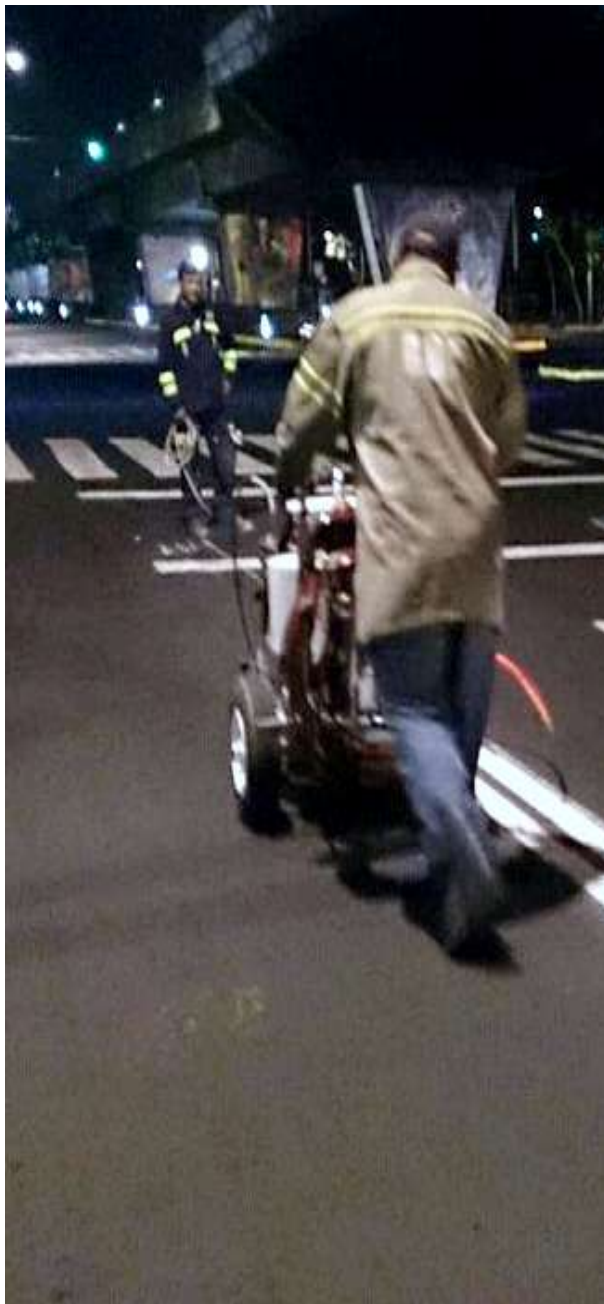
Balizamiento de línea Doble
